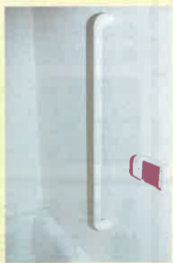
風呂場に取り付けられた緊急通報システム
