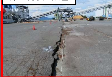
岸壁背後の段差
