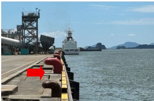
岸壁の被災状況（はらみ出し）
