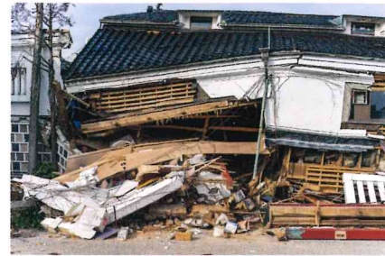
地震による被害例 (能登半島地震)
