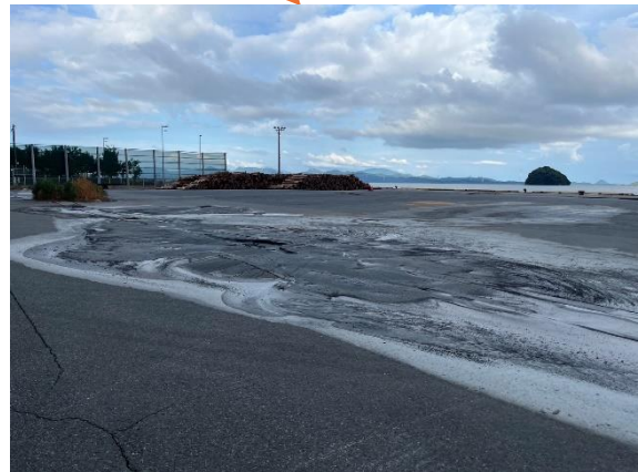
荷さばき地の液状化による被災（外港地区）
