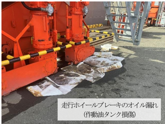
ガントリークレーンの被災
