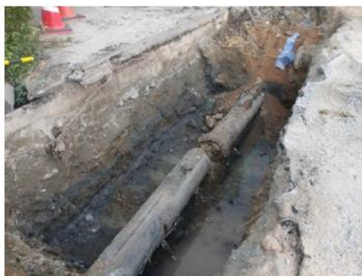
水道管の被害
