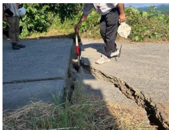
製材所敷地内の舗装の亀裂
