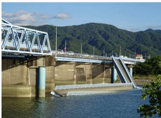
うやなぎばし ▲八代鏡線（植柳橋歩道部）の落橋 （八代市）
