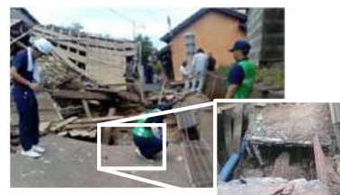
幹線用水路の被災状況
