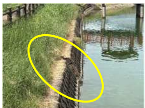
ため池堤体の損傷（宇城市）
