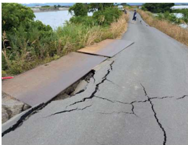
おざやがわ ▲大鞘川における堤防沈下 （八代市）
