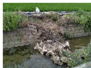
水路の損壊（氷川町）
