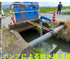
ポンプによる排水路活用
