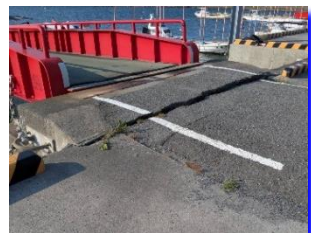
↑浮棧橋の損傷 (赤瀬漁港 (宇土市))
