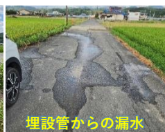
埋設管からの漏水
