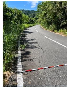
←不知火中腹 基幹農道の亀裂 (宇城市)
