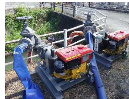
大堰の取水口に設置したポンプ（氷川町）
