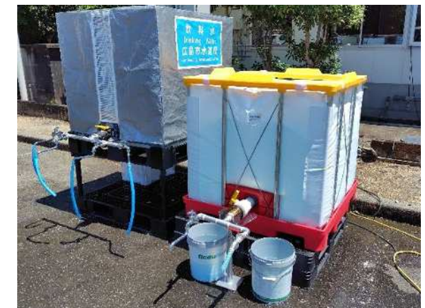
仮設給水タンク
