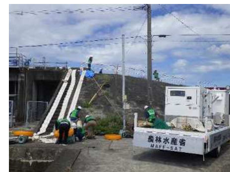
排水ポンプ車配備（八代市）
