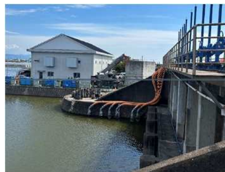
ポンプを活用した排水機能の補完（八代市）
