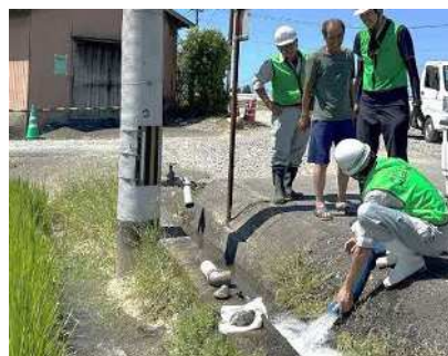
用水路への給水（氷川町）
