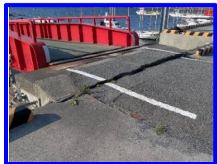
↑浮棧橋の損傷 (赤瀬漁港 (宇土市))
