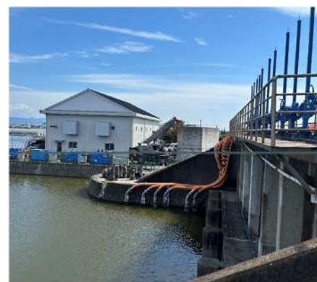
ポンプを活用した排水機能の補完
