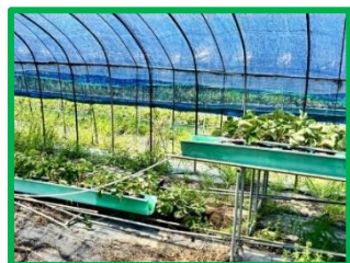
↑イチゴ高設育苗の破損 （八代市）
