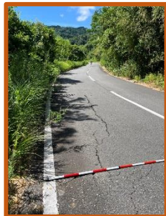
←不知火中腹 基幹農道の亀裂 （宇城市）
