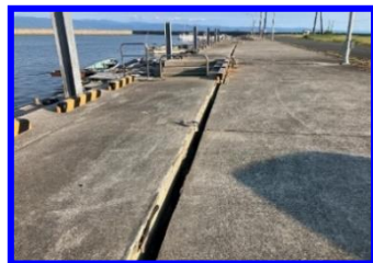
↑物揚場の傾倒・沈下 （郡浦漁港（宇城市））
