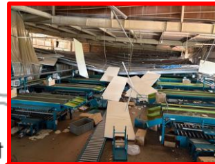
J A 熊本経済連 第二園芸集送センターの損壊→ （宇城市）
