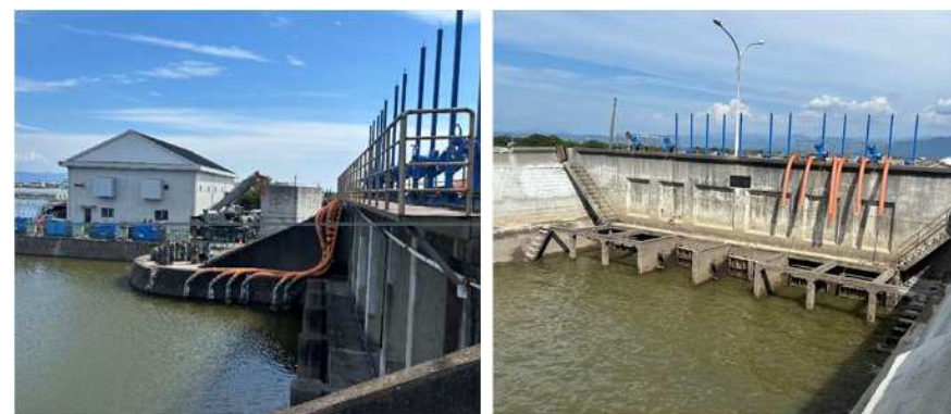
ポンプを活用した排水機能の補完
