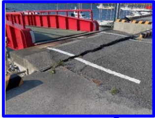
↑浮棧橋の損傷 (赤瀬漁港 (宇土市))
