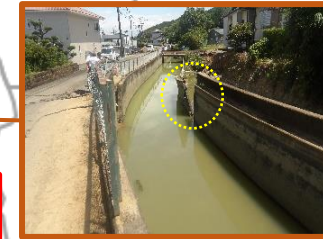
不知火幹線水路の 崩壊 (八代市)
