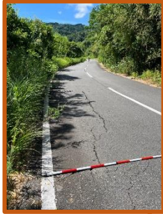
←不知火中腹 基幹農道の亀裂 (宇城市)
