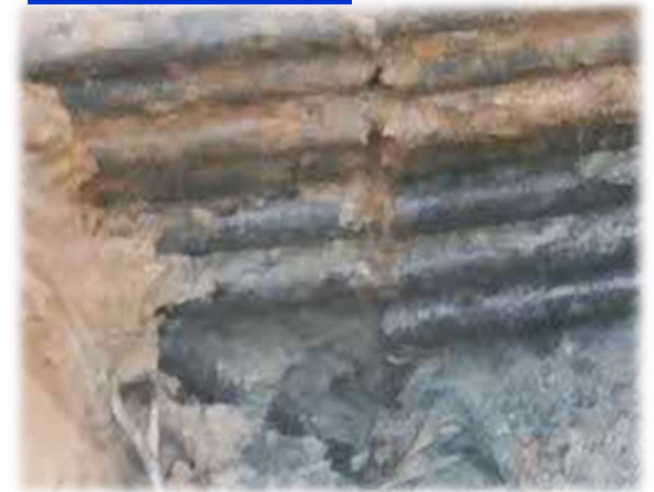
埋設管路損傷
