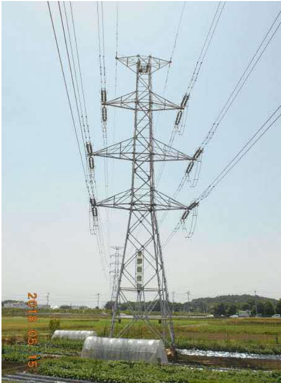
22万ボルト送電線
