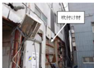
吹付け材が露出している例
