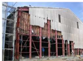
破損、落下したスレート波板
