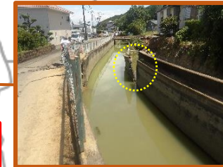
不知火幹線水路の 崩壊 (八代市)
