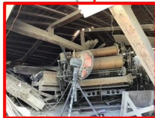
いぐさ製織作業場の倒壊→ (八代市)
