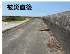
被災直後 舗装の損傷
