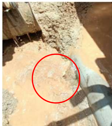
施工前（パイプライン漏水箇所）
