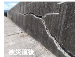
波返(パラペット)の亀裂
