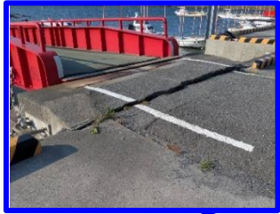
↑浮栈橋の損傷 (赤瀬漁港 (宇土市))
