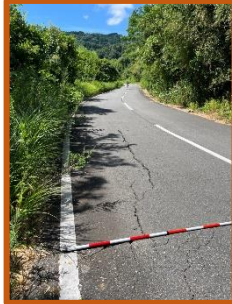
←不知火中腹 基幹農道の亀裂 (宇城市)
