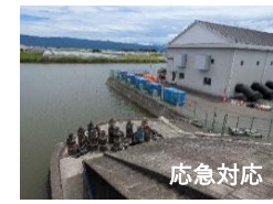
応急ポンプの設置
