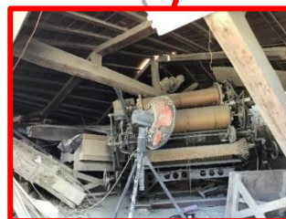
いぐさ製織作業場の倒壊→ (八代市)
