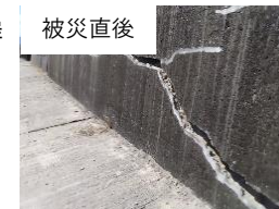
波返(パラペット)の亀裂
