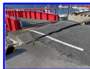
↑浮棧橋の損傷 (赤瀬漁港 (宇土市))
