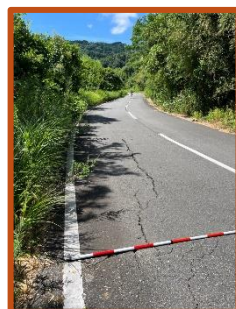
←不知火中腹 基幹農道の亀裂 (宇城市)
