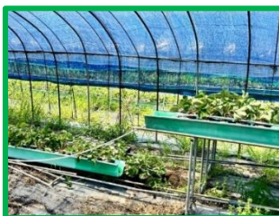
↑イチゴ高設育苗の破損 （八代市）
