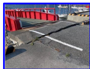
↑浮棧橋の損傷 (赤瀬漁港（宇土市）)
