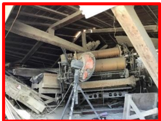
↑いぐさ製織作業場の倒壊 (八代市)
