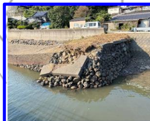
防波堤空石積崩落→ (合串漁港 (津奈木町))
