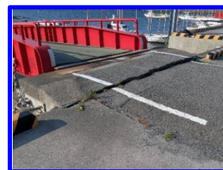
↑浮棧橋の損傷 (赤瀬漁港 (宇土市))
