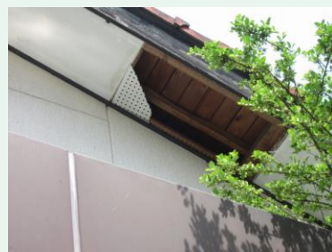
地震で破損した軒天井のけい酸カルシウム板第1種(有孔板)
