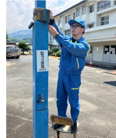
避難所（氷川中学校）への 防犯カメラ設置
