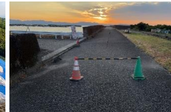
日奈久海岸通行止め (八代市)
