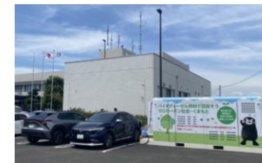
移動式急速充電器@氷川町役場
