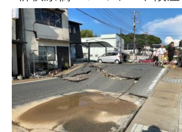
小川嘉島線（宇城市） 路面段差
