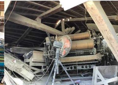
いぐさ製織作業場の倒壊 （八代市）
