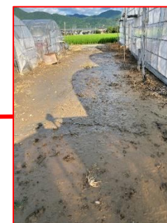
花きハウスの液状化 (八代市)
