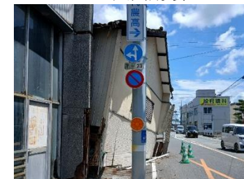
八代鏡宇土線（八代市） 倒壊建築物
