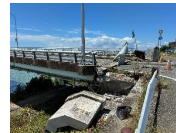
国道 219 号（八代市） 新萩原橋 ジョイント段差
