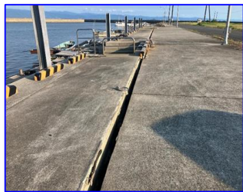
物揚場損傷 (郡浦漁港 (宇城市))
