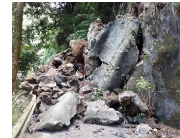
三本松甲佐線（甲佐町） 法面崩壊
