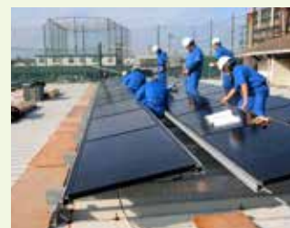
太陽光発電設備(屋上実習)
