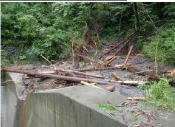
治山ダムが土砂・流木を捕捉し、国道への流出を抑制（高知県吾川いの町）
