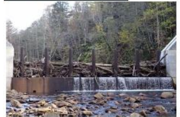
流木捕捉式治山ダムが流木を捕捉し、下流への流出を抑制（北海道名寄市）
