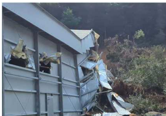
写真2 土砂崩れによる被害 (採卵鶏飼養農場)
