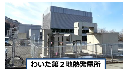
わいた地熱発電所
