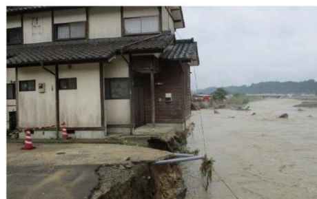
住宅基礎の流出 (新城内団地)
