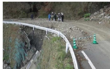
法面崩壊による道路寸断
