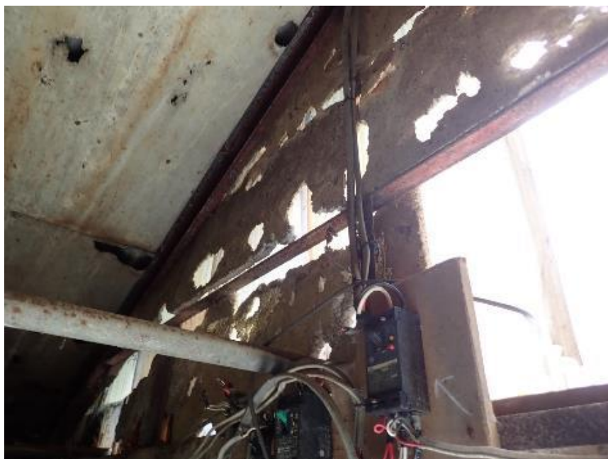
豚舎壁面の破損部
