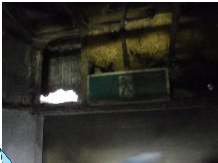
豚舎壁面の破損部
