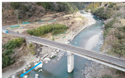
被害状況（令和2年7月時点）
