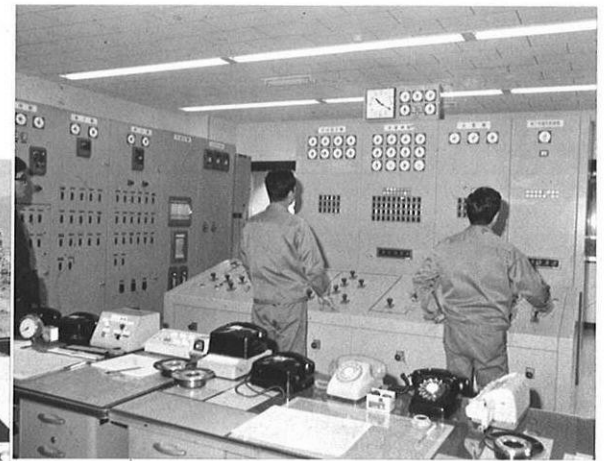
▲高度な計量装置をもつ発電所内の調整室。
