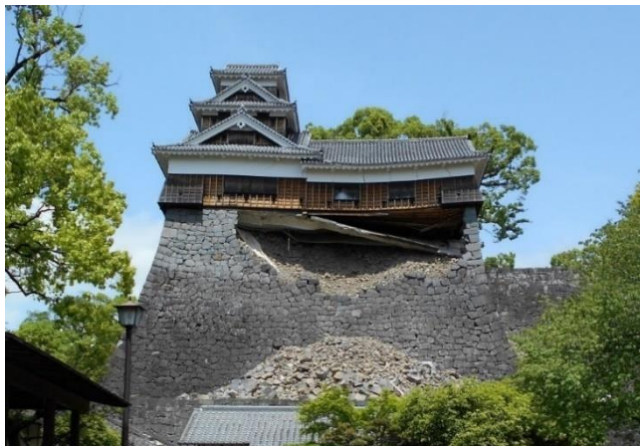
2016年4月22日 飯田丸五階櫓被災状況
