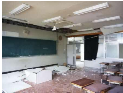
【天井の脱落(校舎)】
