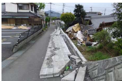
【ブロック塀の倒壊】
