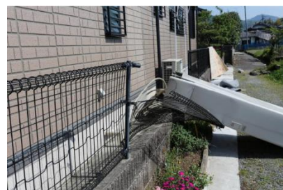
【給湯施設の転倒】 (熊本大学減災型社会システム実践研究教育センター)
