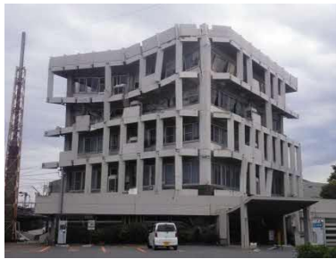
【庁舎棟の局部崩壊】
