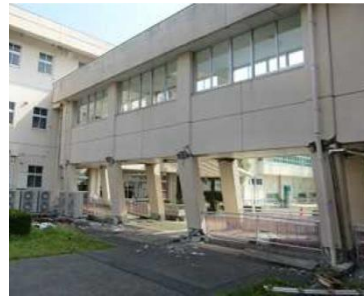
【渡り廊下の倒壊(校舎)】 (写真:熊本県教育委員会)
