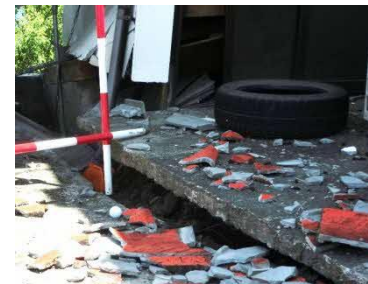
【建築物の外周地盤の沈下】
