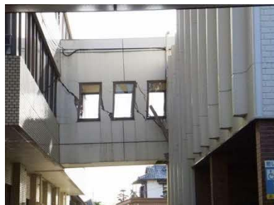
【渡り廊下の被害】
