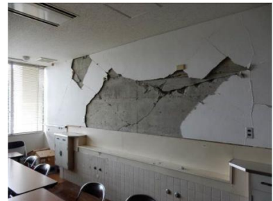
【耐力壁のせん断ひび割れ】 (写真:国立研究開発法人 建築研究所)
