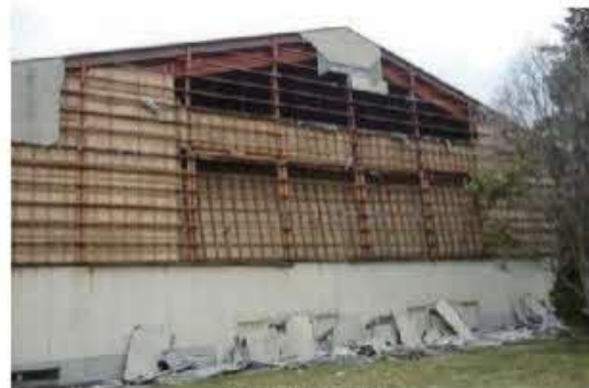
外装材の脱落
