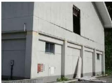
外壁材の脱落
