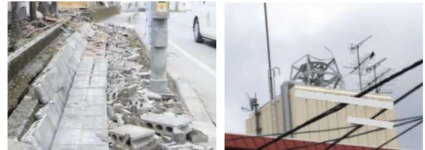
図 4.6.5 ブロック塀・屋上突出物の被害 (写真:国土交通省)
