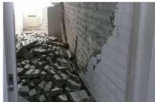
間仕切り壁の損傷
