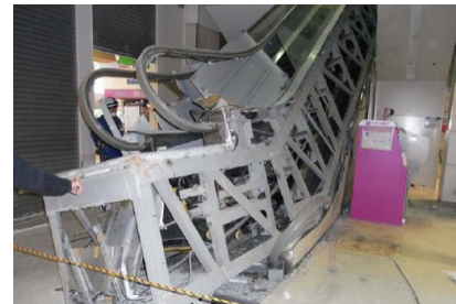
図 4.6.4 エスカレーター落下 （写真：国土交通省）
