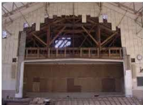
ステージ前部の壁の脱落
