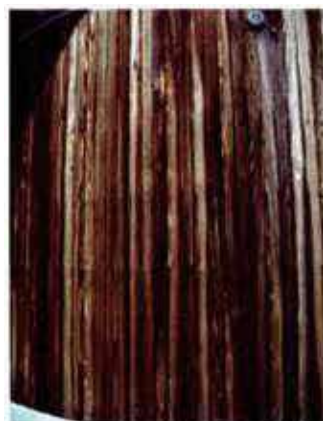
写真1 木製外壁の灰色化 右側は日当たりや雨降りが多く灰色化している。左側、灰色化した後でも両側の色やデザインとマッチするよう設計すれば、灰色化の悪影響を抑えることも可能である。
