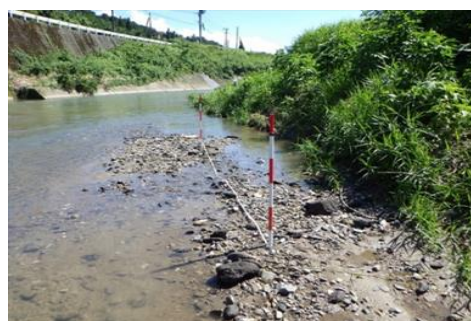
土砂堆積状況
