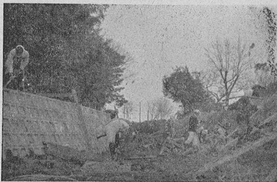
幸野溝の改修工事……河壁はブロックで、底はコンクリートで固める
