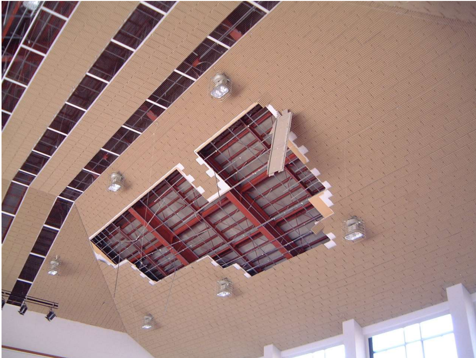
内装材(天井パネル)の落下危険性
