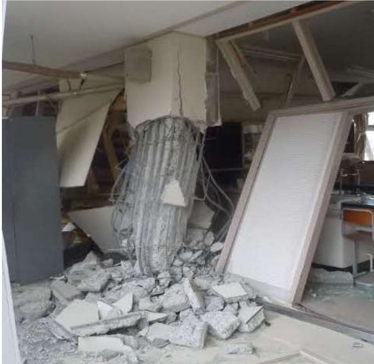
せん断破壊した柱（東日本大震災）
