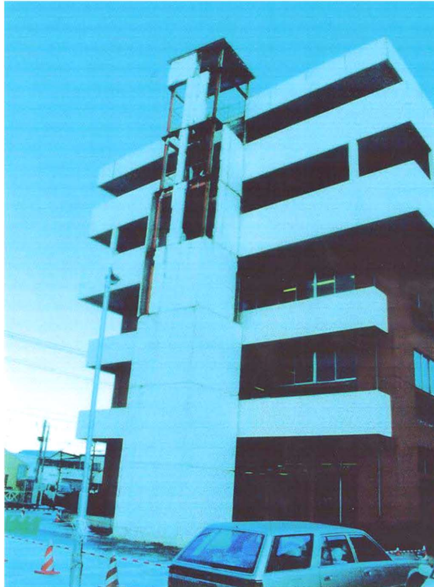
鉄骨外階段の外装材(ALC版)の落下危険性
