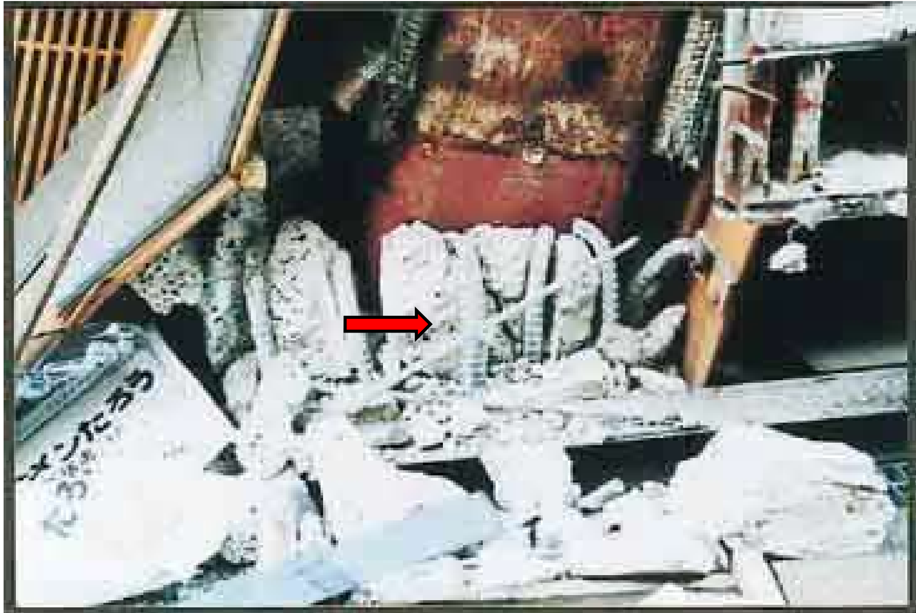
根巻き高さが十分でない根巻き柱脚の移動
