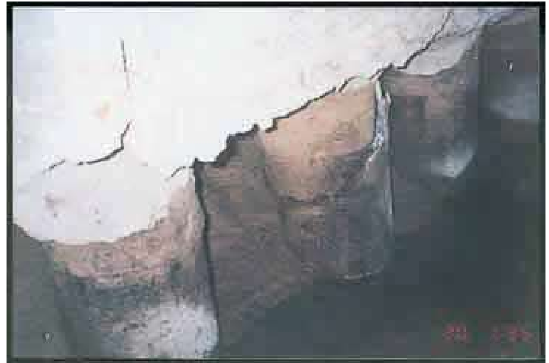
杭の著しい破損
