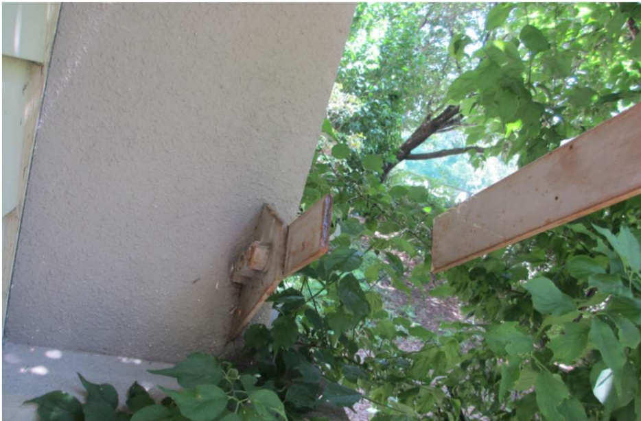
フラットバー筋違の座屈
