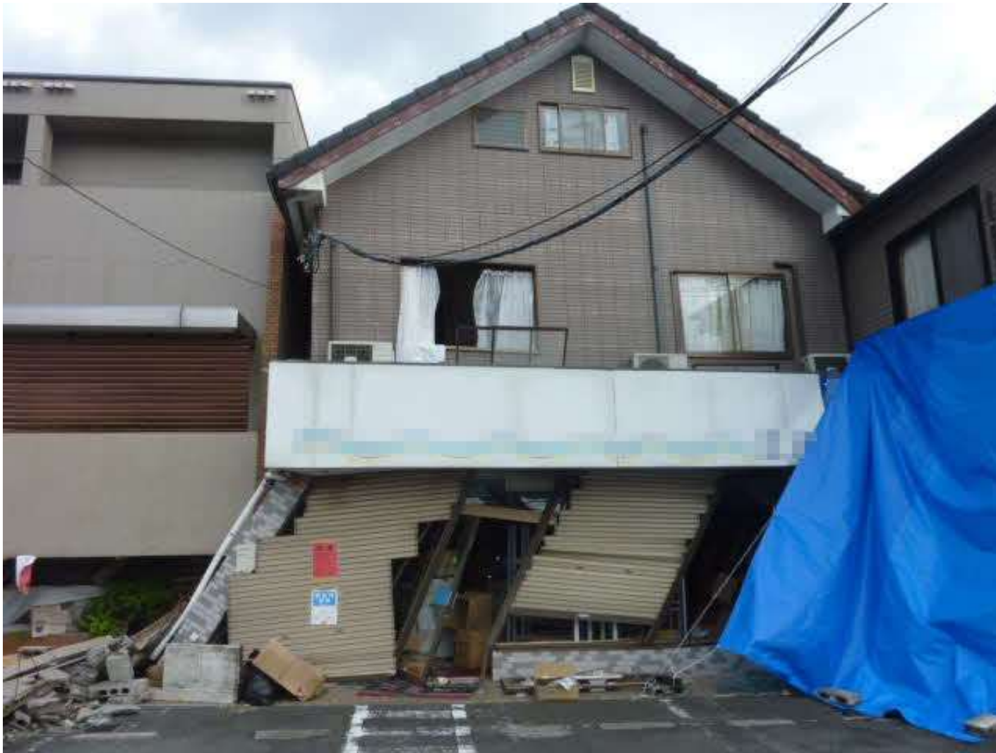
隣接建築物の倒壊による建物の破壊
