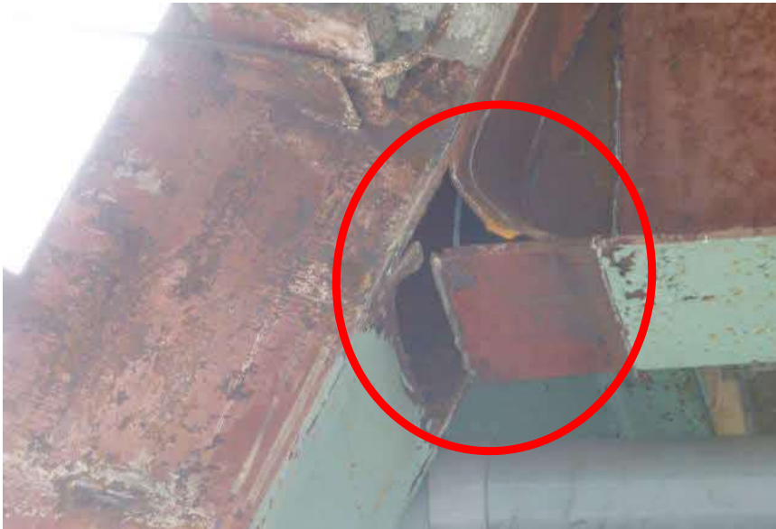
柱と梁の溶接部の破断
