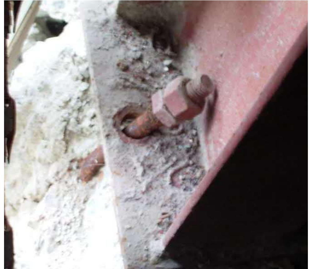
アンカーボルトの伸び、基礎RC破損
