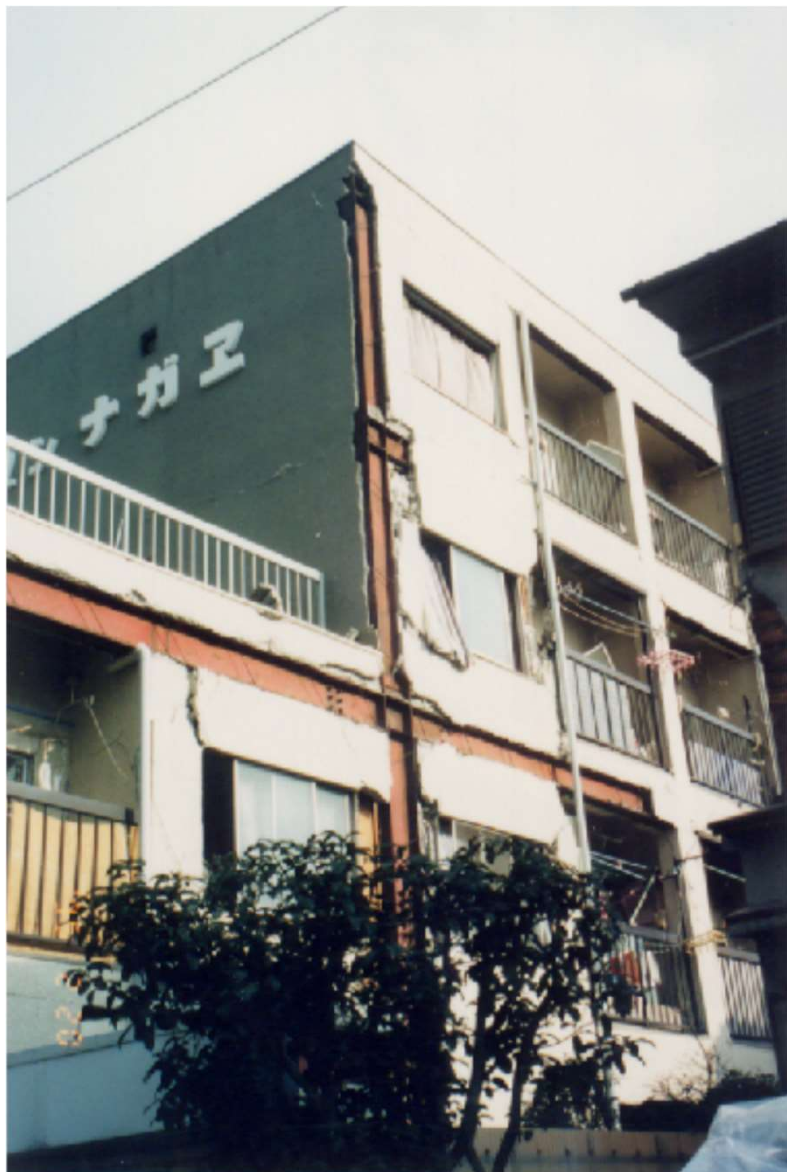
外装材(乾式)の落下危険性
