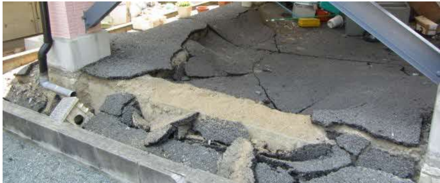
地盤が不同沈下した建築物周辺
