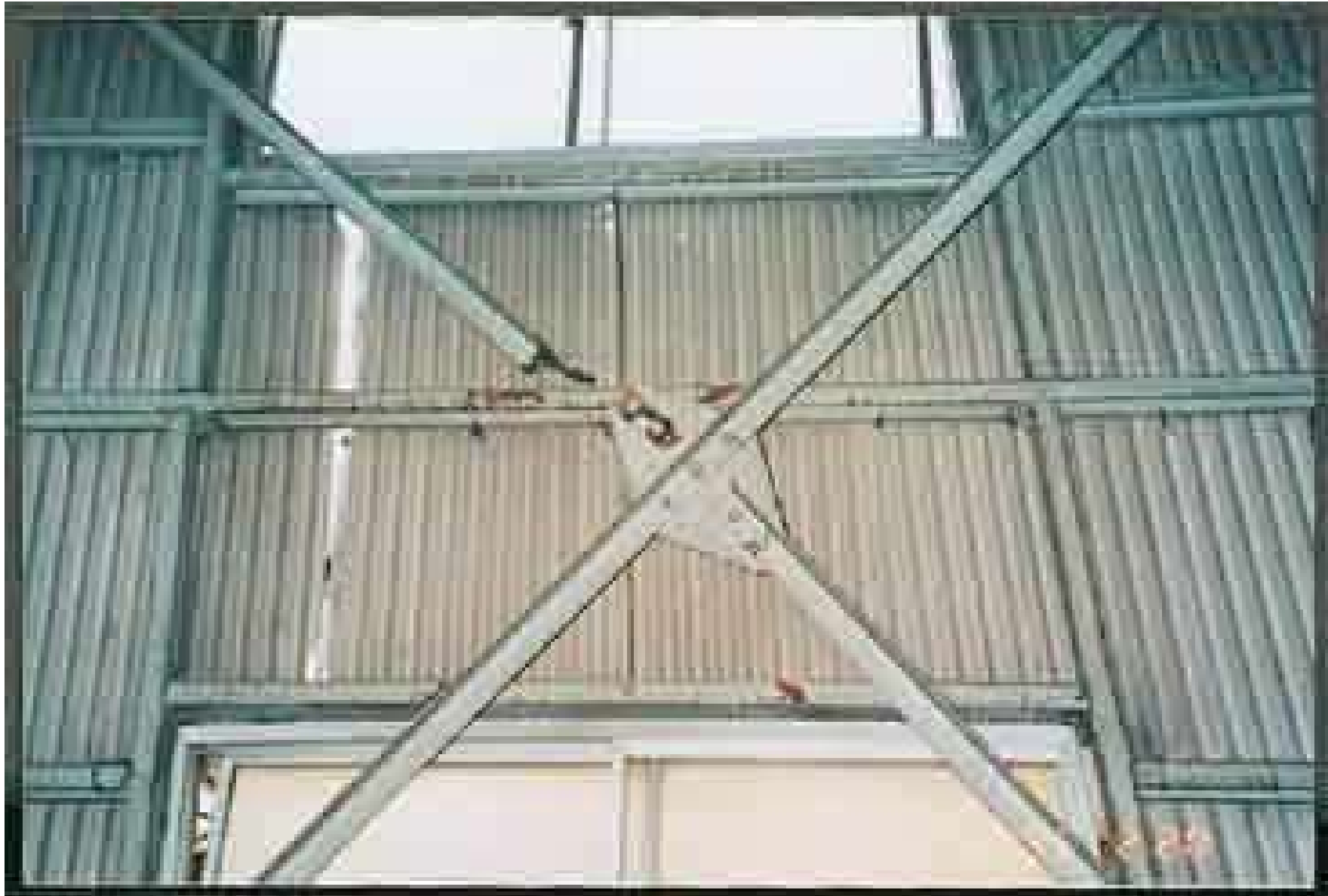
アングル筋違の破断
