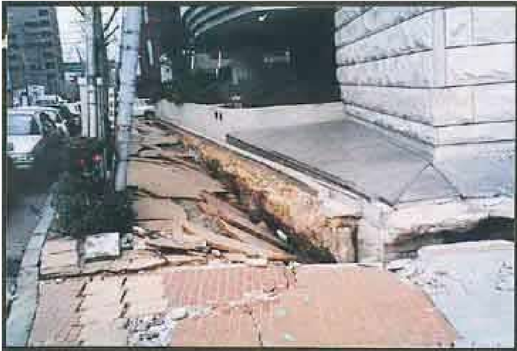
地盤の液状化のため沈下した建築物周辺
