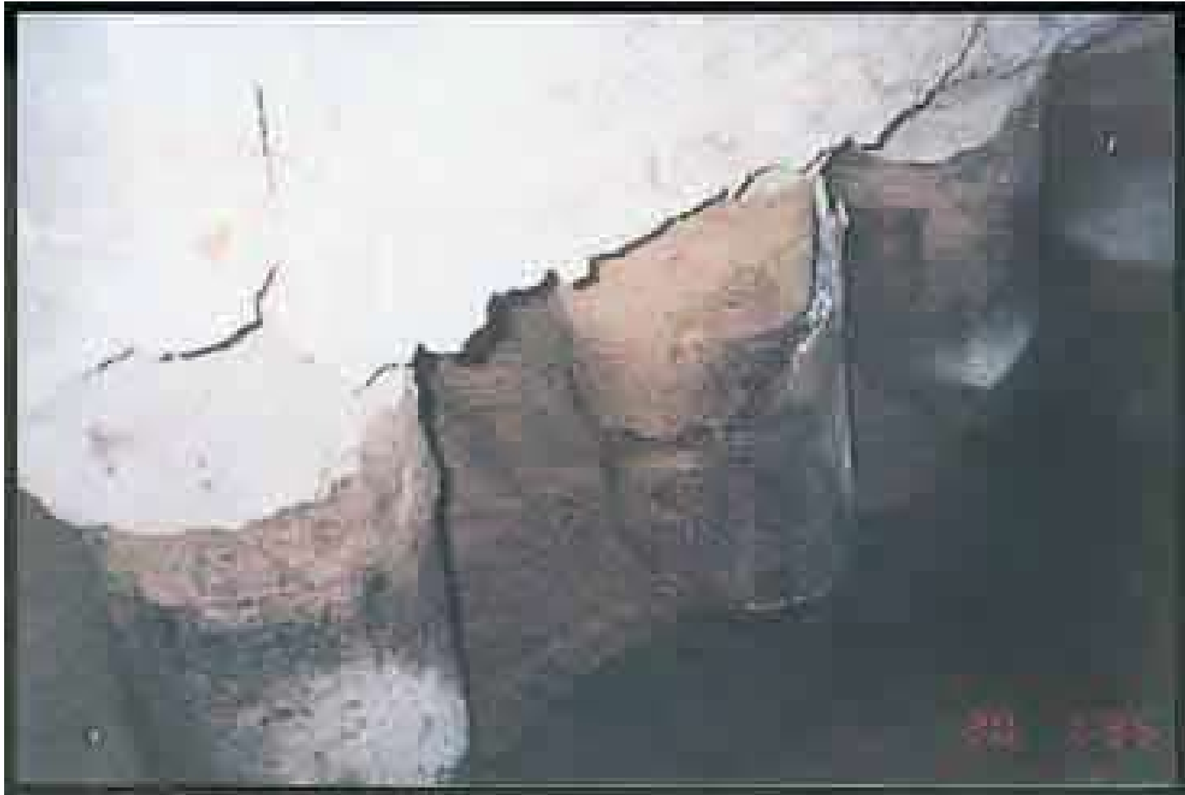
杭の著しい破損
