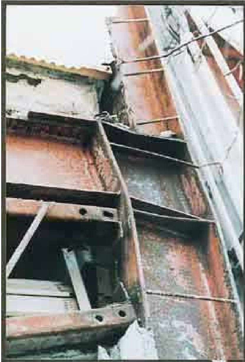
H型鋼の柱材の腐食及び局部座屈
