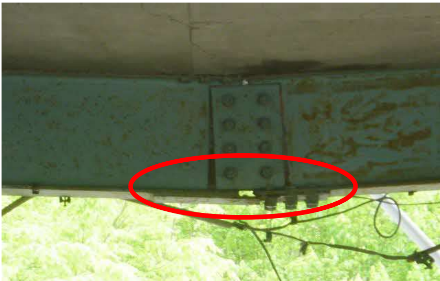
梁の継手部分の損傷
