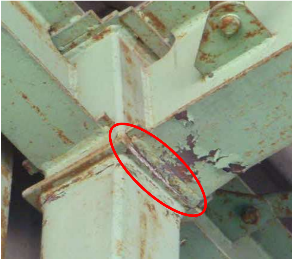
梁と通しダイヤフラムとの 溶接部の破断
