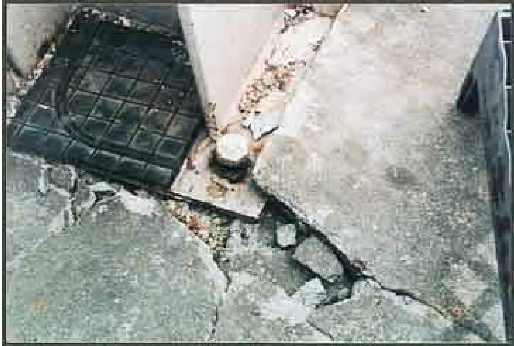
アンカーボルトの伸び、モルタルひび割れ
