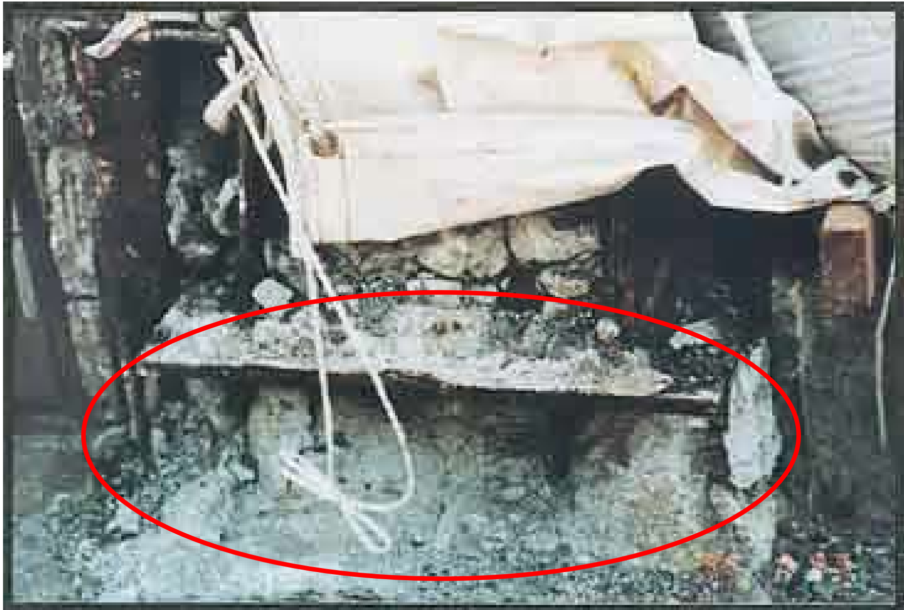
柱脚ベースプレート下部コンクリートの圧壊
