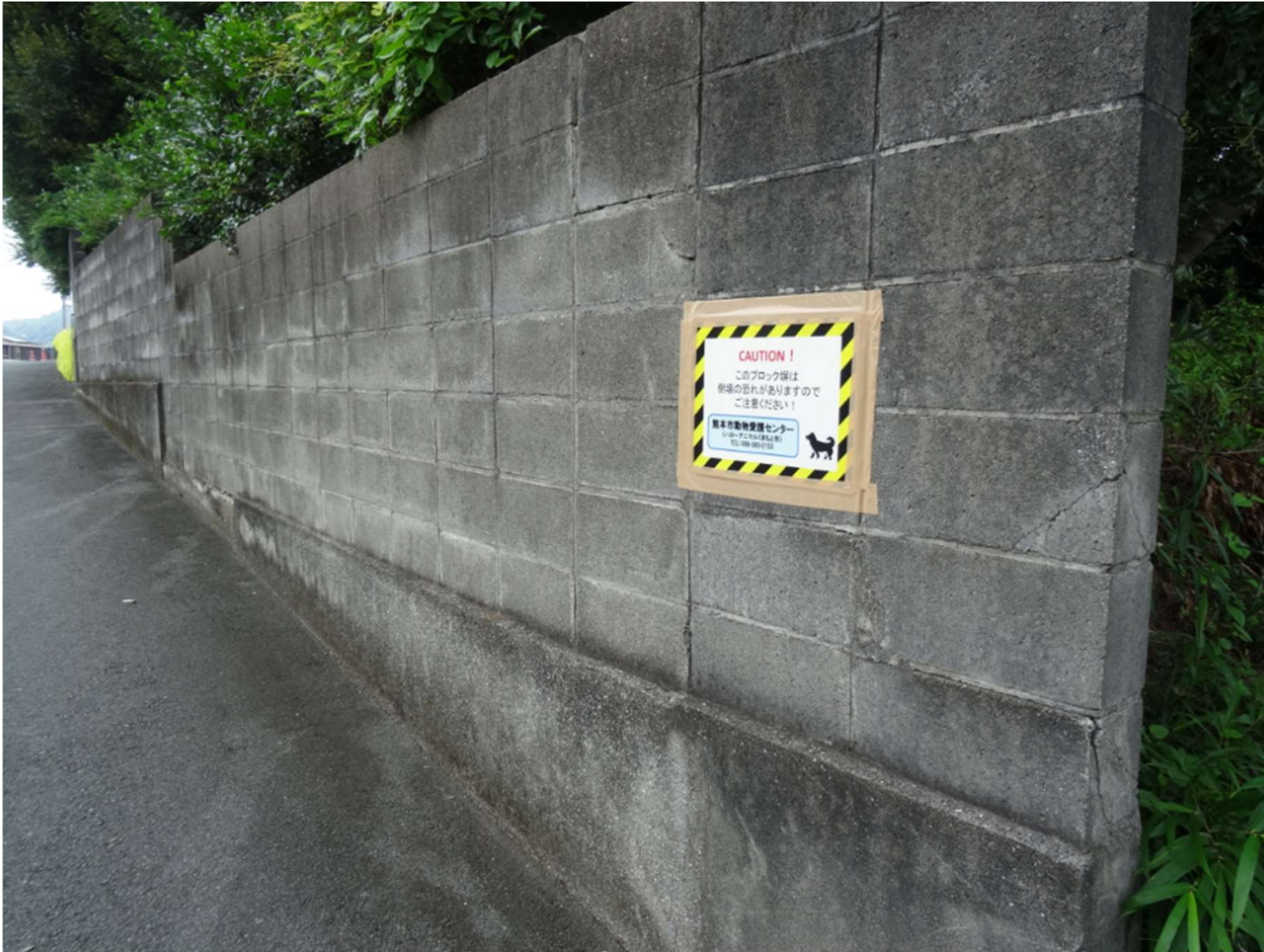
傾いており転倒の危険性のあるブロック塀
