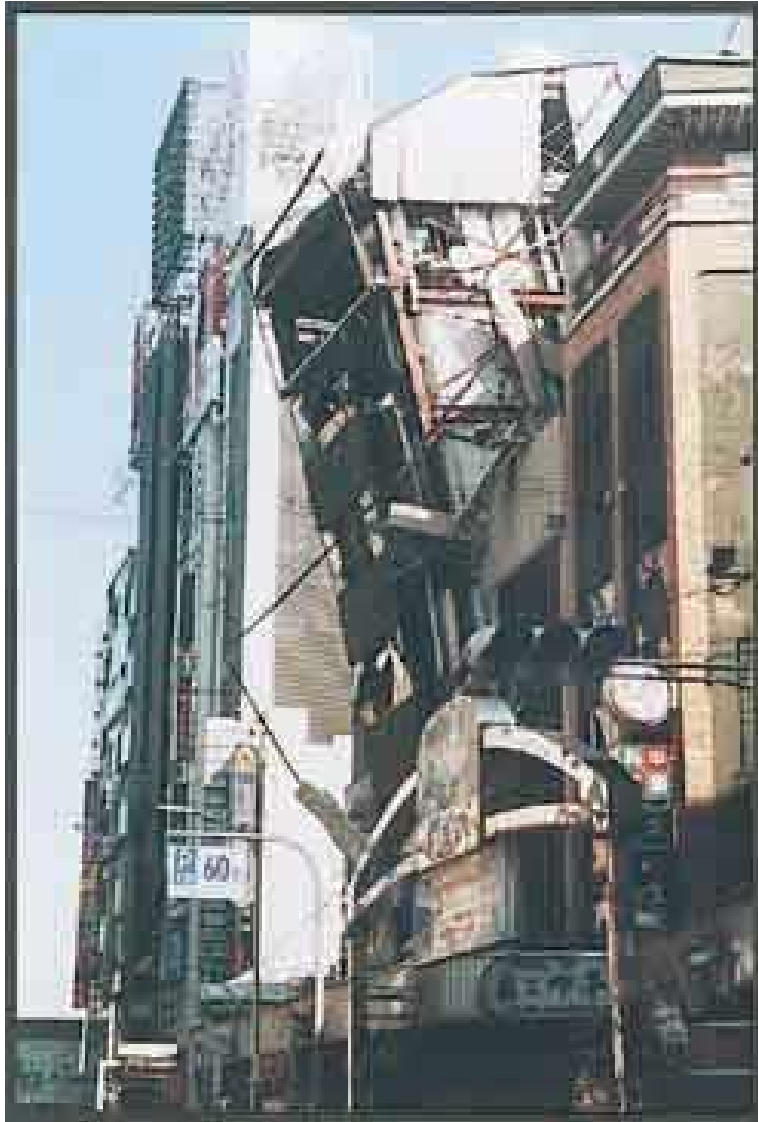
著しく傾斜した建築物
