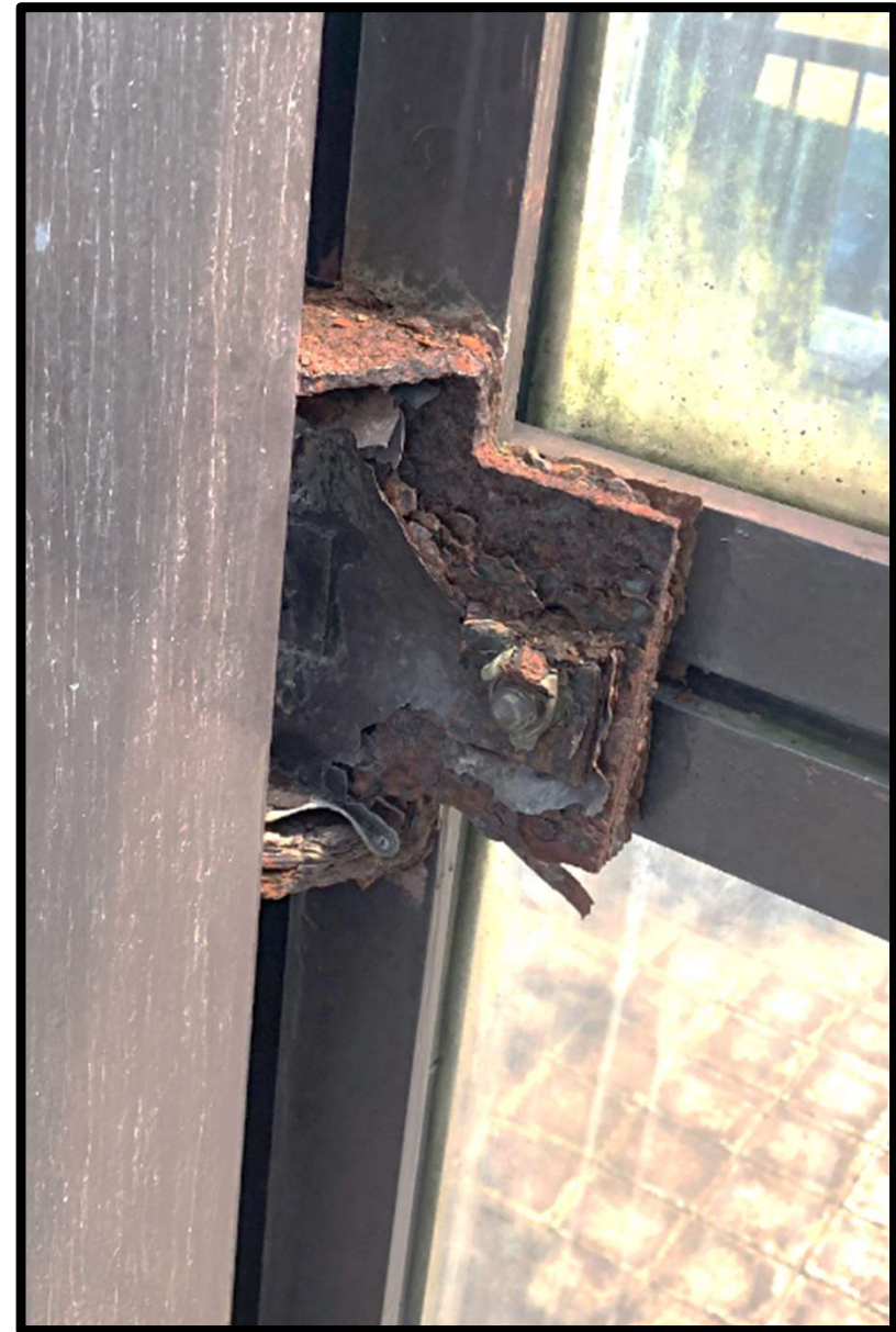
鋼材の腐食による板厚減少
