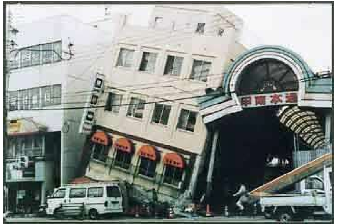
アーケードへの倒壊の危険性のある建築物
