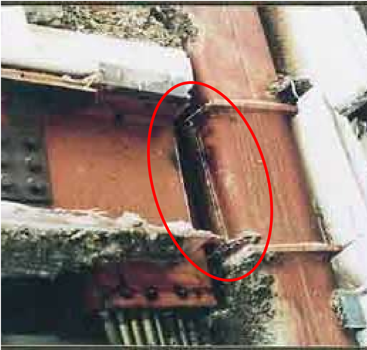
角形鋼管柱と梁端部の溶接部の破断
