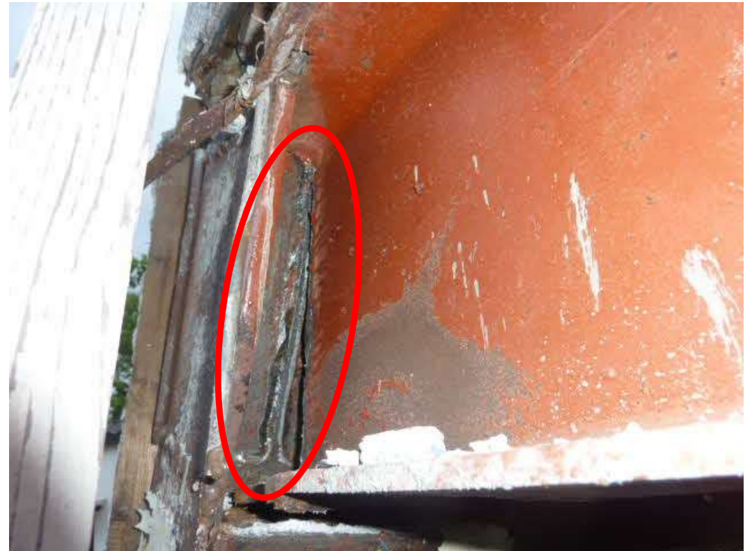
梁端部の溶接部の破断
