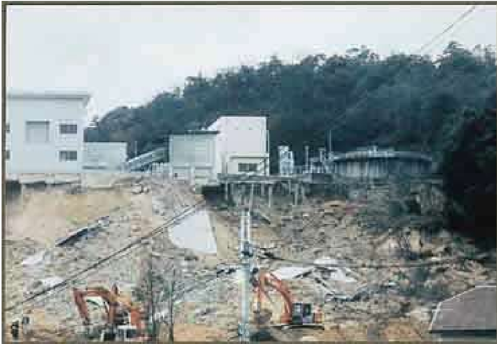
建築物の敷地の崩壊の危険
