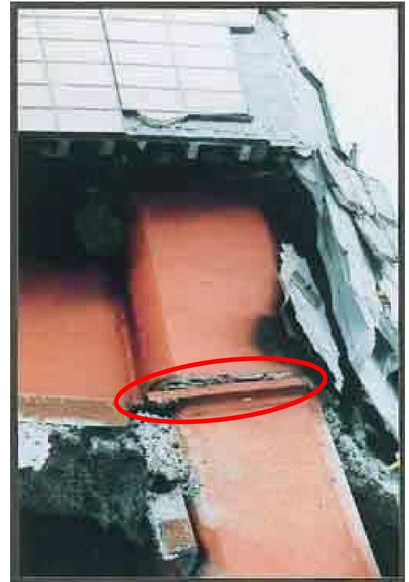
柱と通しダイヤフラムとの 溶接部の破断
