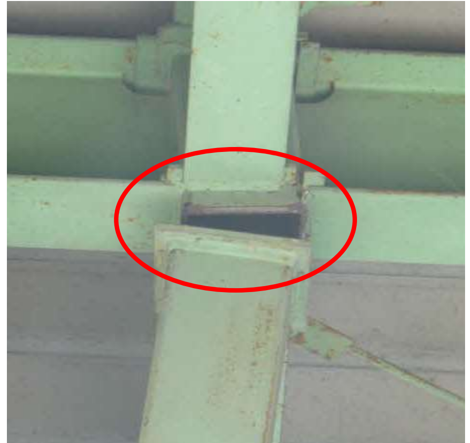
柱と通しダイヤフラムとの 溶接部の破断
