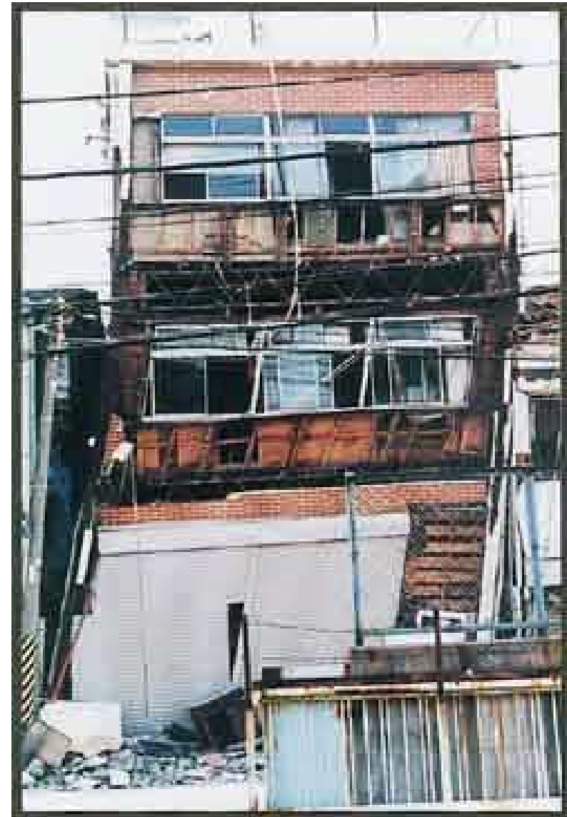
1階及び2階にのみ傾斜を生じた建築物
