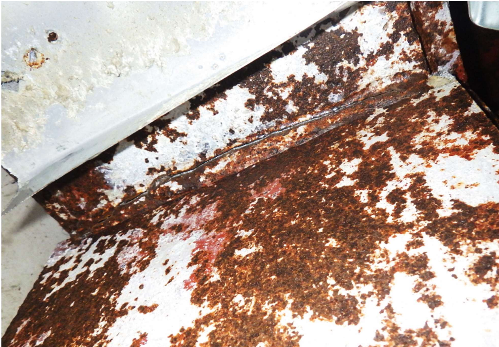
隅肉溶接部のひび割れ・破断
