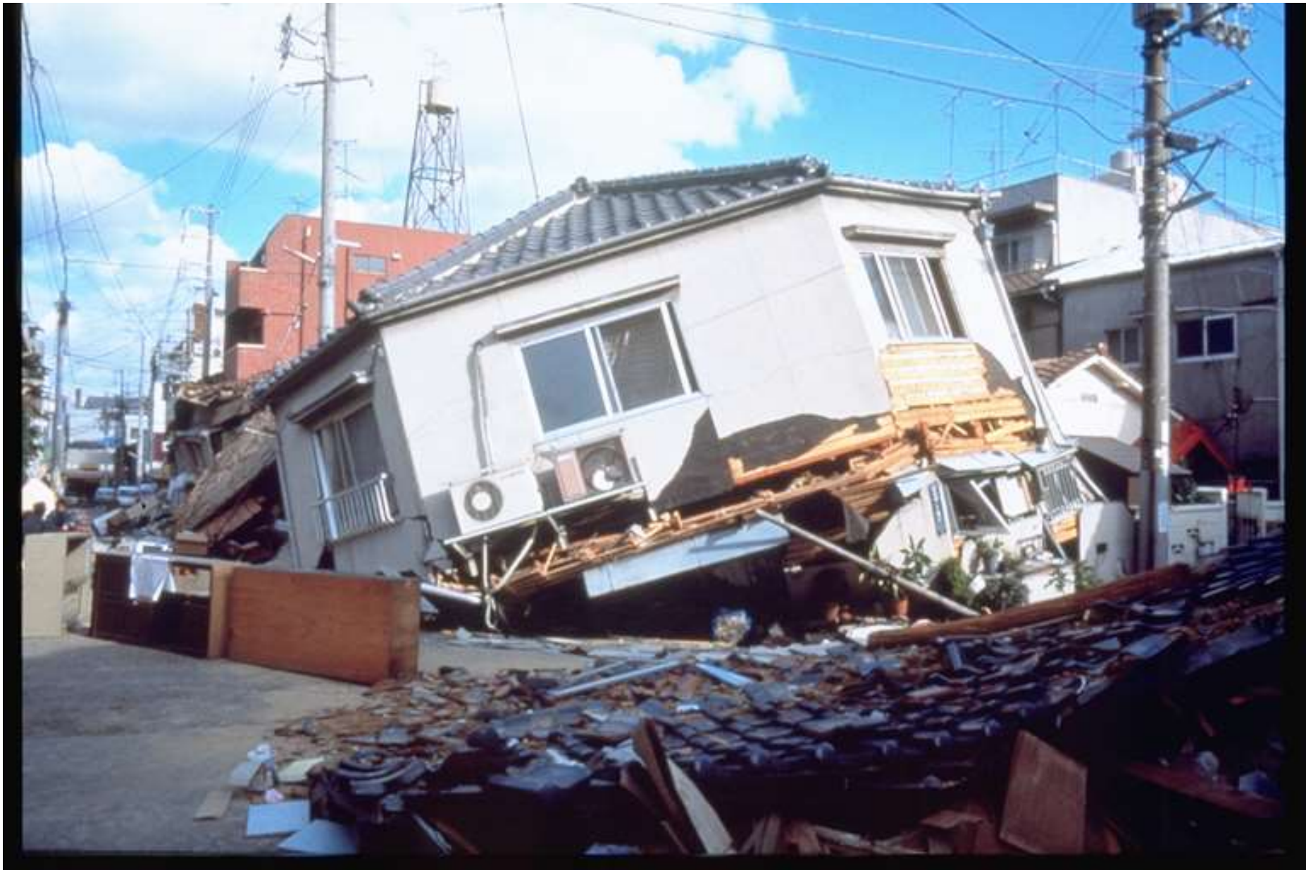
2階建店舗併用住宅。1階崩壊。
