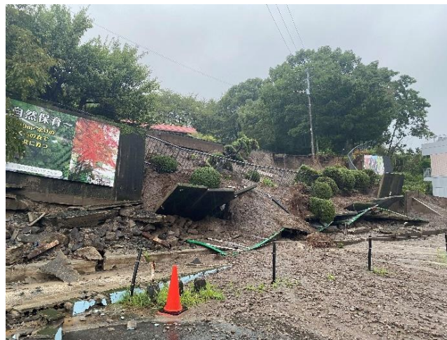
玉名市の保育園（法面崩壊）
