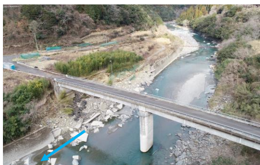
被害状況（令和2年7月時点）
