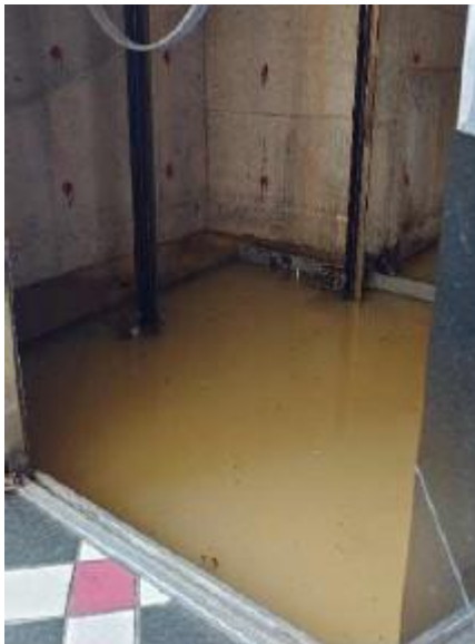
ホテルエレベーターの浸水被害の様子（天草市）
