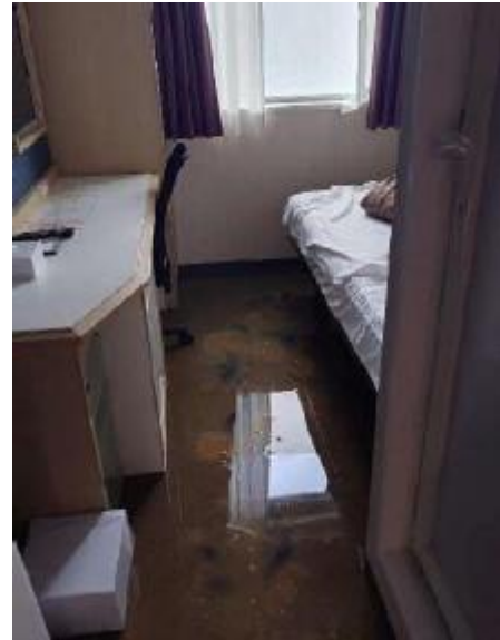
ホテル客室内の浸水被害の様子（天草市）
