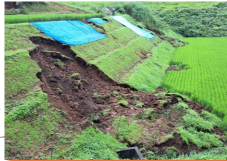
農地法面崩壊 【菊池市木庭町】
