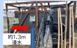
ハウス内暖房機の浸水
