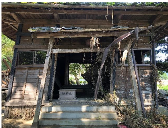
(令和2年7月22日・文化課) 被災状況
