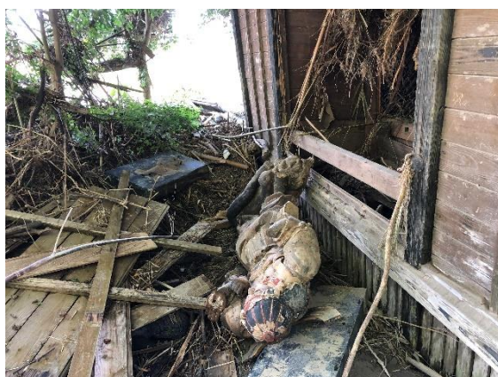
(令和2年7月22日・文化課) 被災状況
